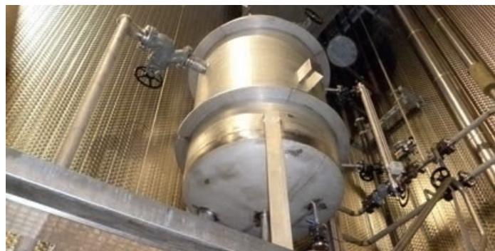
Flash-tanks scheiden flash-stoom van condensaat. Door het condensaat vervolgens terug te voeren kan het hergebruikt voor stoomopwekking.
