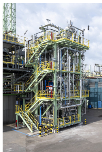
QPinch-heat transformer bij Borealis
