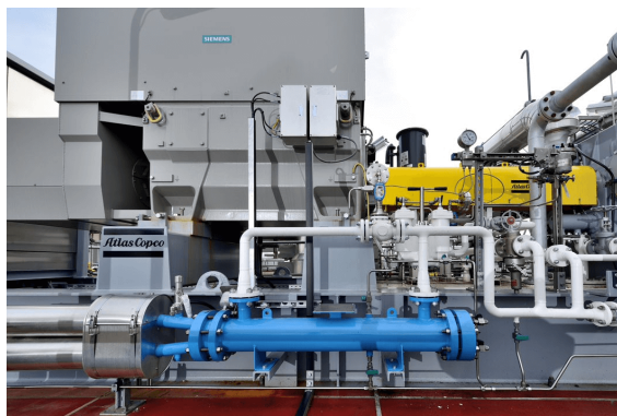
Mechanische damp recompressie installatie in Terneuzen
