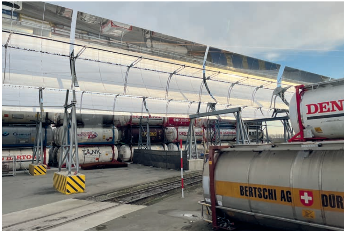
De opbrengst van het zonnespiegelpark bedraagt jaarlijks 450 MWh.
